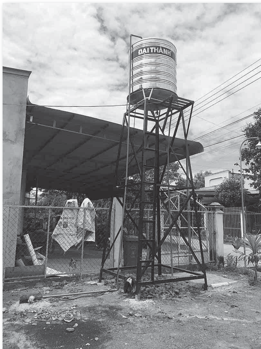
Puits collectif installé avec l'aide de Terre des Hommes Alsace
